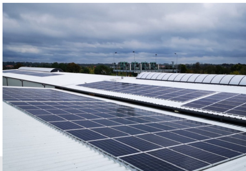
Zdjęcie: Instalacja fotowoltaiczna dla firmy
