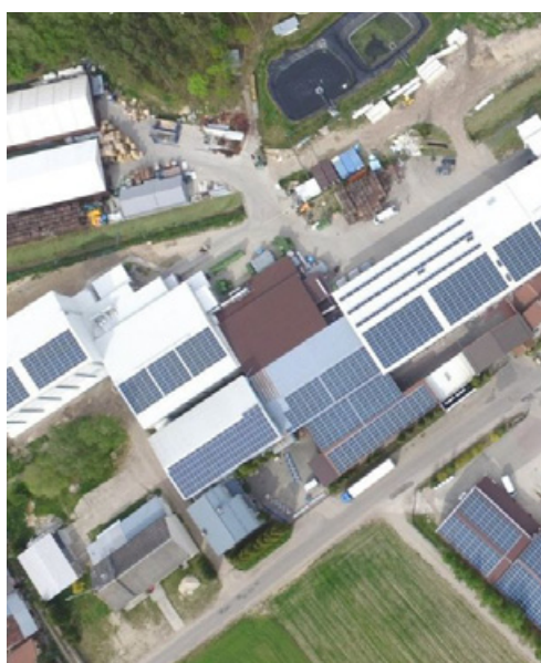
Zdjęcie: Instalacja fotowoltaiczna dla firmy
